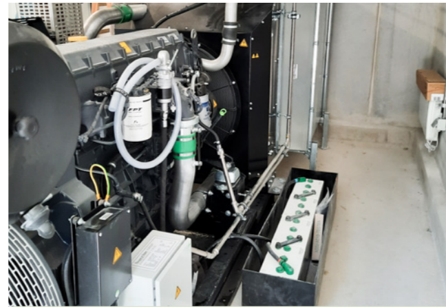
Februar 2022: Notstromaggregat „Hochbehälter Weltenburg“
