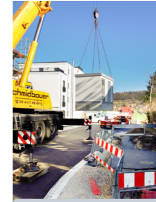
April 2022: Trafostation Kelheimwinzerstraße
